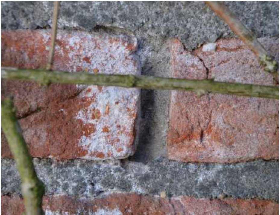
Een deel van de voeg is verdwenen (foto Rob Vereijken)
